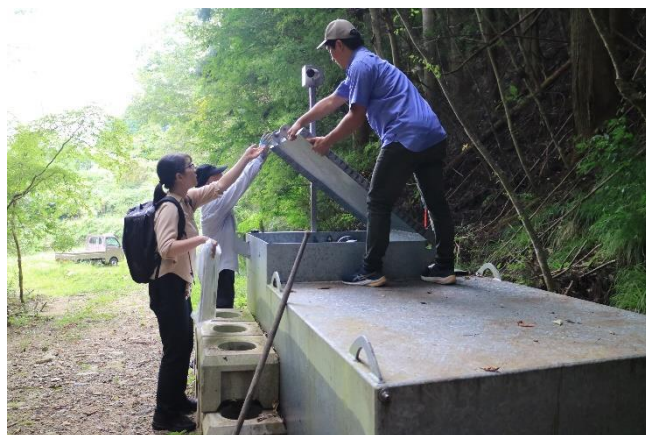
農業用水から発電用と余剰水を分け、排砂もする分水槽。
